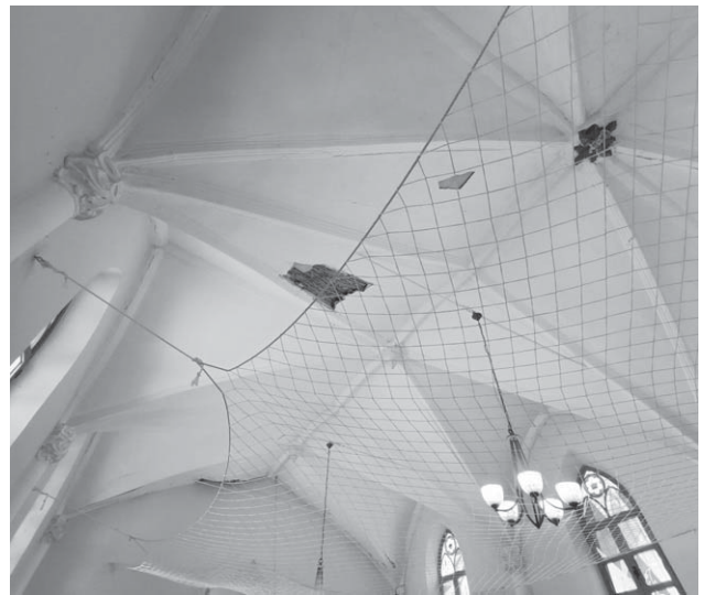
Desprendimientos en el techo de la iglesia.
